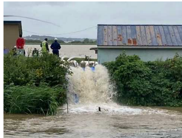
湛水の排水状況 (東北町高瀬川)
