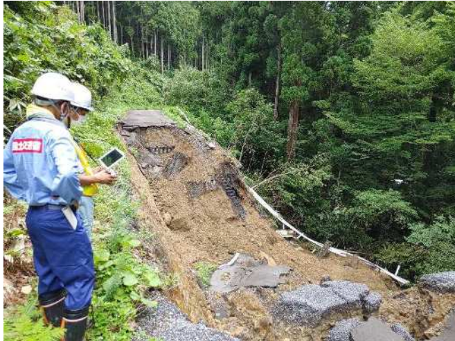
(中泊町) UAV映像による被災状況調査 (袴腰山地内)
