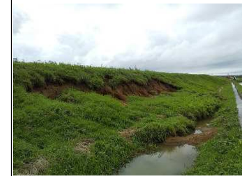
▲法裏崩壊状況
