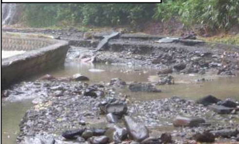
被災状況：8月12日撮影
