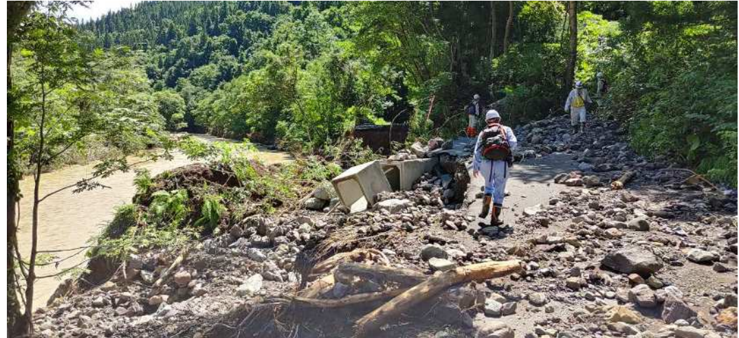
(鱒ヶ沢町) 被災状況調査 (町道赤石溪流線)
