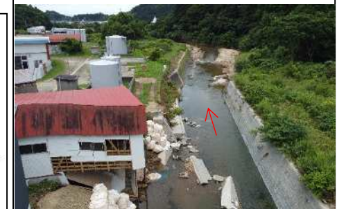
▲倉庫の被災状況
