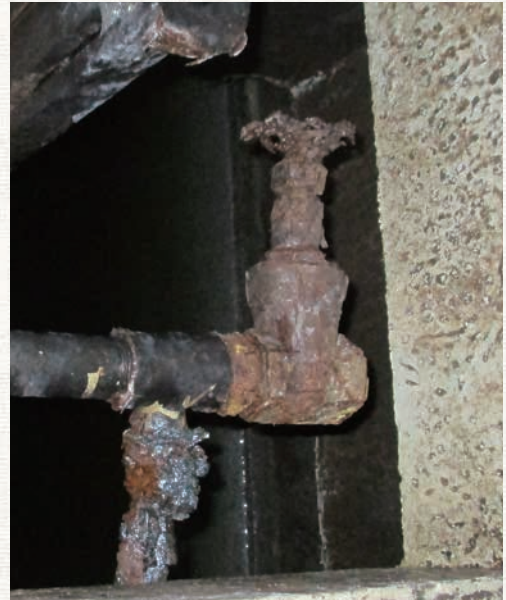
槽内のガスにより腐食したバルブ
