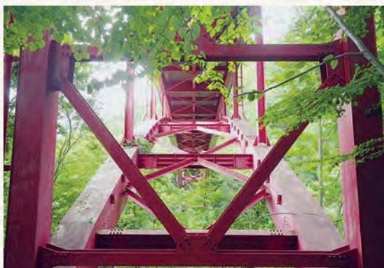
県道 西目屋二ツ井線 釣瓶橋（補修前）
