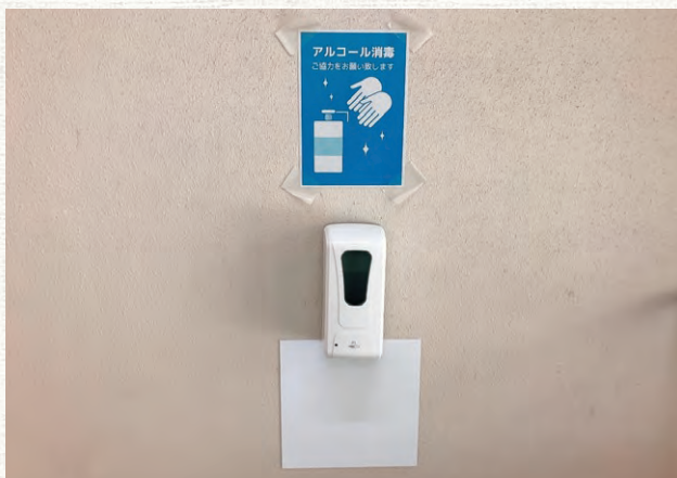
写真2 アルコール消毒装置(自動噴霧になっている)
