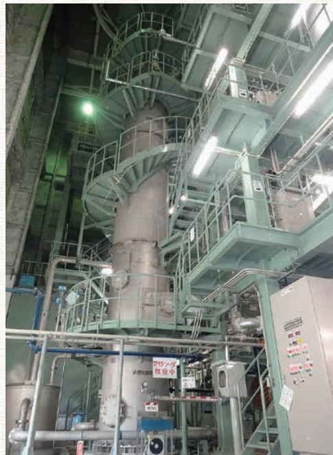
排ガス洗浄装置
